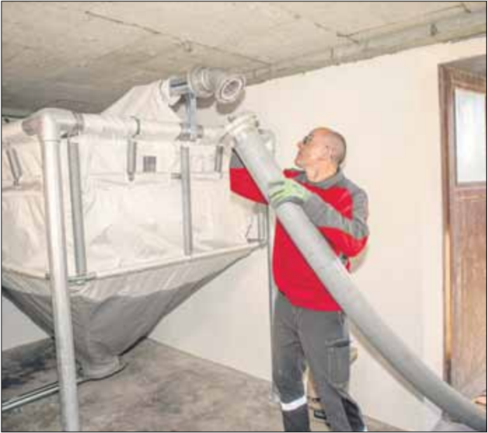
txn. Ein Pelletlager wird oft dort eingebaut, wo vorher die Heizöltanks standen. Dadurch ist der Aufwand für den Einbau der klimaschonenden Pelletheizung vergleichsweise gering. Foto: Deutsches Pelletinstitut/txn
