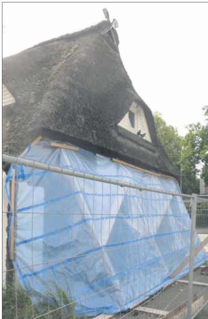
Die Giebelwand der Schulkate: Nur provisorisch gesichert
