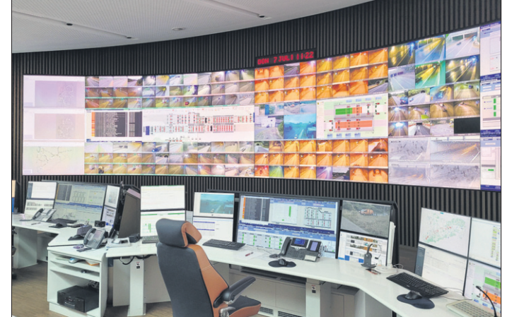
Rund um die Uhr haben die Tunnelleitzentralen die Sicherheit der Anlagen im Blick. Foto: DJD/Scholz & Friends
