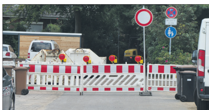
In der Gartenstraße in Schenefeld wird am Ende der Straße gebaut. Es entsteht ein sogenannter „Wendehammer“. Wichtig für Lieferfahrzeuge und besonders Müllwagen, die ansonsten die Abholung einstellen.
